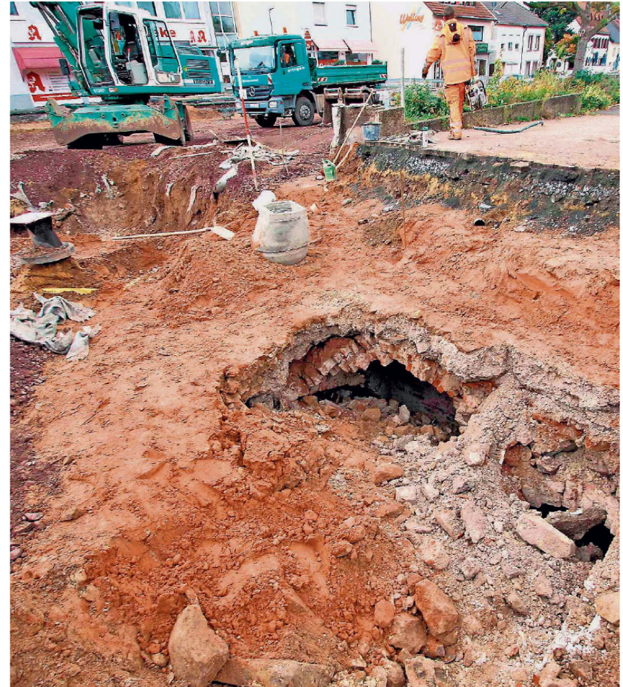
Hohlräume der alten Wallerfanger Steingutfabrik am nördlichen Rand des so genannten Fabrikplatzes sorgen für Verzögerungen beim Bau des Wallerfanger Kreisels. FOTO: JOHANNES A. BODWING
